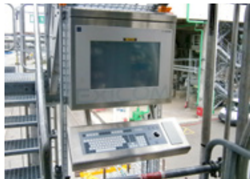
Abb. 2 Seit Mitte 2014 ist die neue Tankabfüllung bei BASF in Betrieb Foto: BASF
