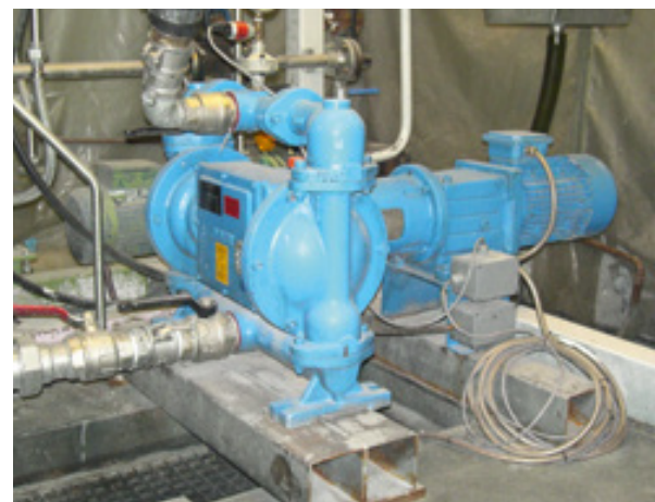
Elektromechanische Membranpumpe zur Leimumwälzung
