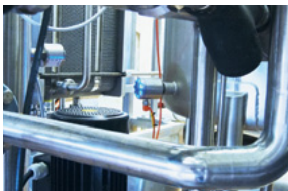
Abb. 1 Füllstandsüberwachung in einem Behälter
