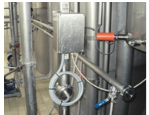
Abb. 2 Der in der Hauptleitung eingebaute LiquiSonic® Varivent-Sensor misst bei FrieslandCampina kontinuierlich den TS-Gehalt während der Molkeindampfung.
