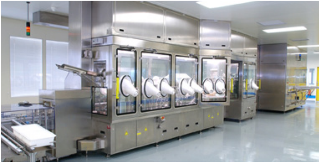
Abb. Abfüll- und Verpackungsanlage mit katalytischer Belüftung des Isolators, die für sehr schnelle Produktwechsel sorgt
