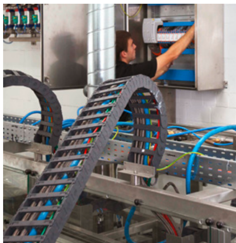
Abb. 2 Das Unternehmen Motip Dupli setzt das Remote-I/O-System in einer Abfüllanlage ein.
